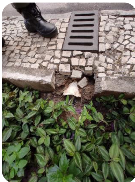
Figura 9 – Calçada adjacente ao jardim de chuva danificada
