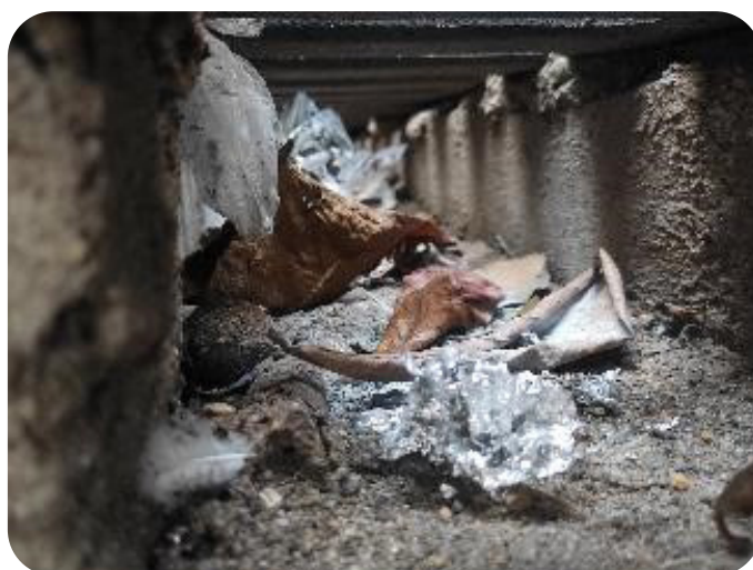
Figura 10 – Resíduos orgânicos e inorgânicos na canaleta de drenagem
