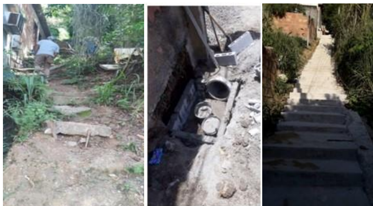
Figura 5. - Fotos das obras da comunidade do Cabrito mostrando o antes, durante a implantação da rede de drenagem em beco da comunidade e o depois com a drenagem e a pavimentação concluídas.
