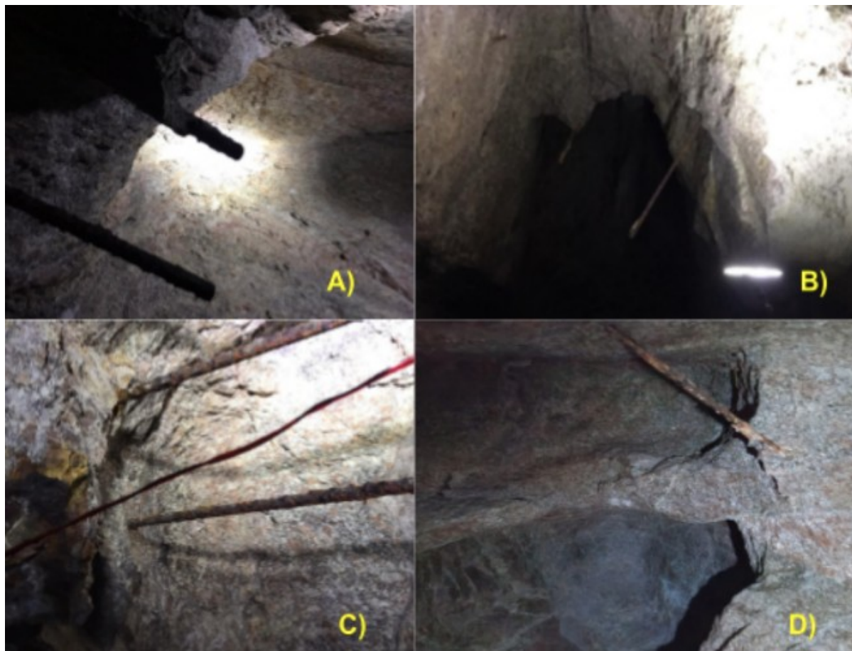
Figura 6.4-2. Observação de diversos trechos do túnel com elemento fixador, com hastes completamente corroídas por corrosão, e destaque para a pequena dimensão da cabeça.
