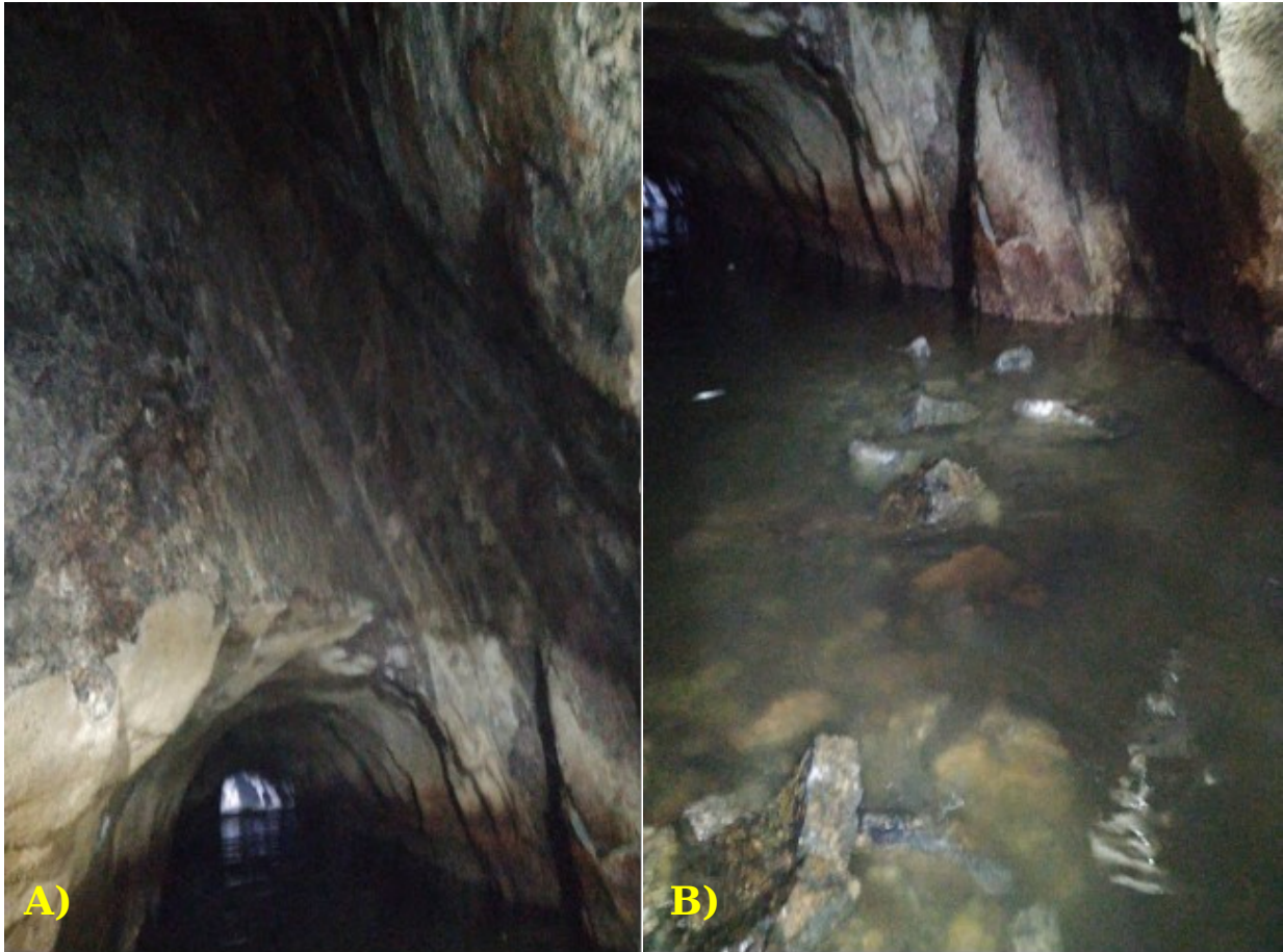
Figura 6.3-2. A) Situação em 12/01/21 mostrando a capela do trecho 110m, mostrando os limites da parede sul da capela, parecidos com os da vistoria anterior. B) Outra vista do mesmo trecho, com enfoque na parede oeste, e mostrando o aumento da cavidade, embora limitado entre os planos de foliação com a mesma dimensão na direção perpendicular à foliação, e aumento nas direções paralelas à foliação.
