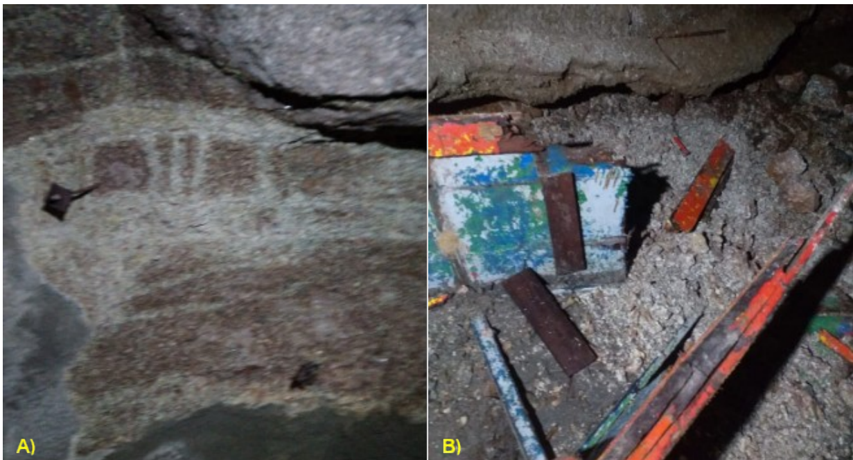
Figura 6.2-4. A) Situação de 05/01/21 mostrando trecho do Respiro, em situação de intersecção de falha geológica com veio pegmatítico, que sofreu ruptura de bloco do teto. B) Detalhe do bloco caído, que danificou a embarcação atracada nessa entrada de serviços (respiro).
