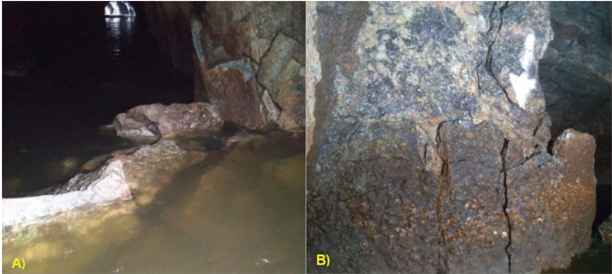
Figura 6.2-3. A) Situação em 28/12/2020 mostrando novo colapso da capela do trecho 110m. B) Detalhe da parede do túnel no trecho 110m, mostrando trechos ainda por cair.
