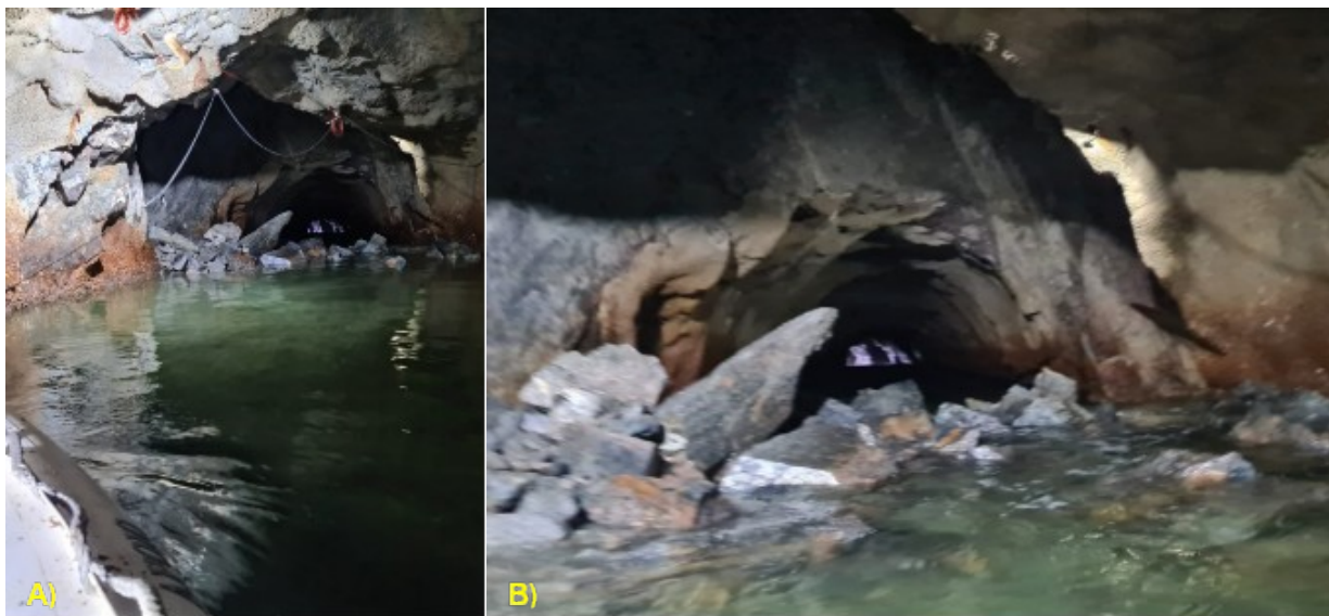
Figura 6.3-3. A) Situação em 13/01/21 mostrando a capela do trecho 110m, mostrando acentuada queda de blocos, quando comparado a situação do dia anterior ( Figura 6.3-2 ). B) Outra vista do mesmo trecho.
