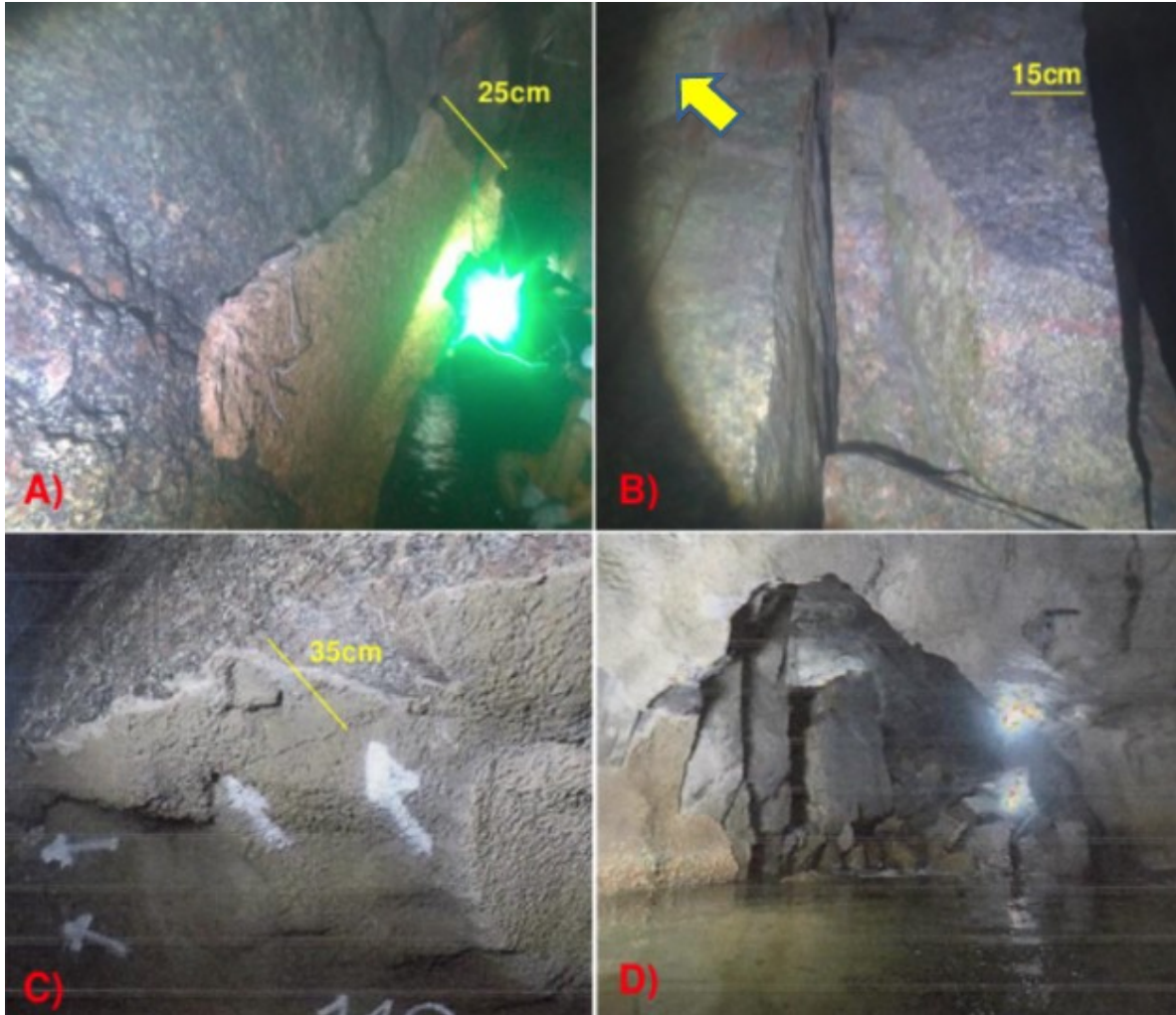
Figura 6.4-3. Observações sobre o concreto projetado: A) Trecho da capela de 110m de concreto com fibra metálica, de espessura ainda assim inferior a 5cm; B) Transição de concreto projetado na parede do túnel no trecho de 110m, mostrando uma espessura mínima do concreto; C) e D) Trecho do limite da capela, para sul e a apresentação da camada de espessura mínima possível de concreto jateado, em desacordo com o memorial descritivo.
