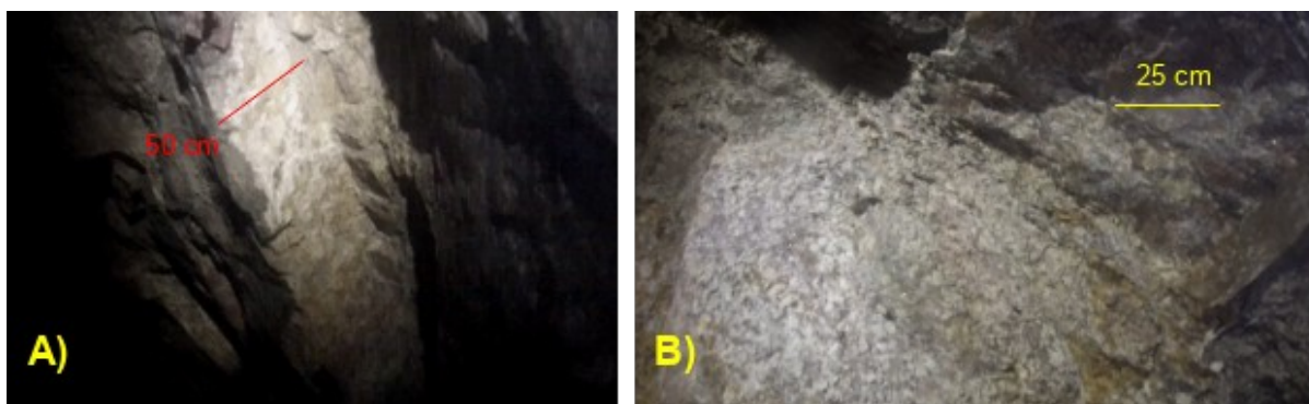
Figura 6.1-3. A) Colapso de teto, na direção da foliação de rocha, em veio pegmatítico caulinitizados. B) Detalhe do veio pegmatítico, mostrando os fenocristais de feldspatos intemperizados e caulinitizados.
