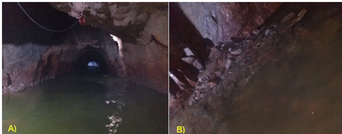
Figura 6.2-5. A) Situação em 07/01/21 após limpeza das quedas de blocos de 28/12/20. B) 11/01/2021 Mostrando novas quedas de blocos após limpeza concluída em 07/01/21.
