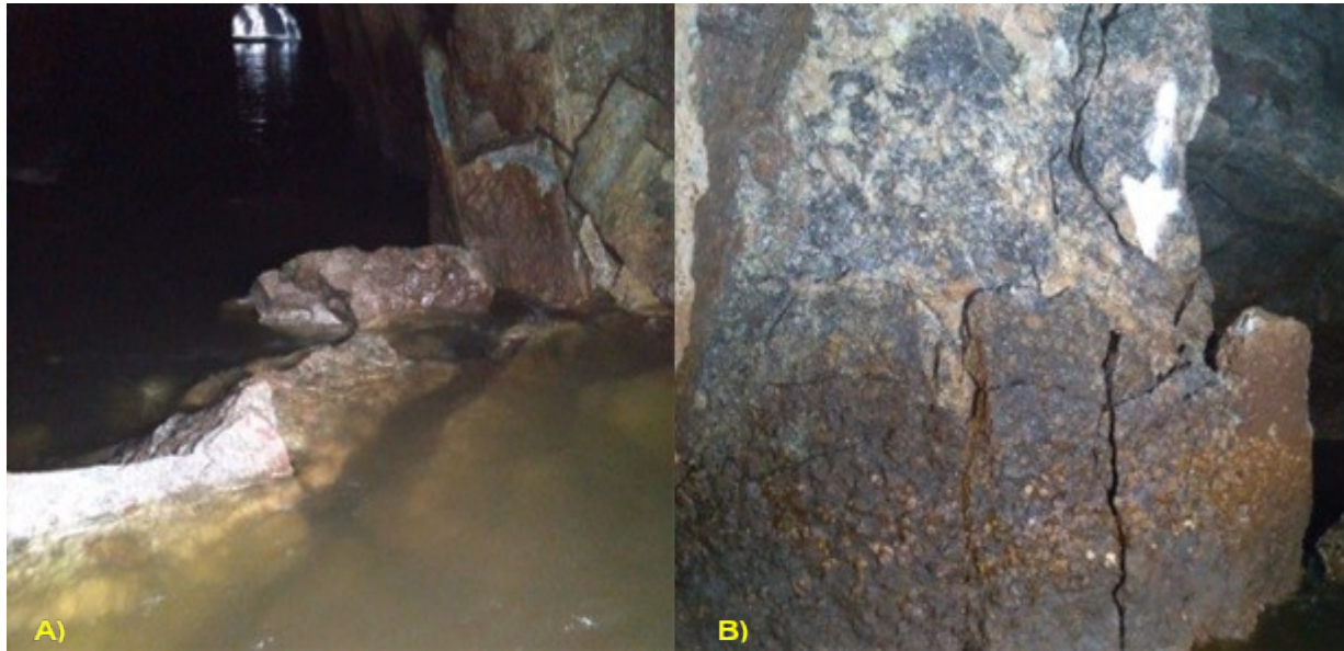
Figura 6.2-3. A) Situação em 28/12/2020 mostrando novo colapso da capela do trecho 110m. B) Detalhe da parede do túnel no trecho 110m, mostrando trechos ainda por cair.
