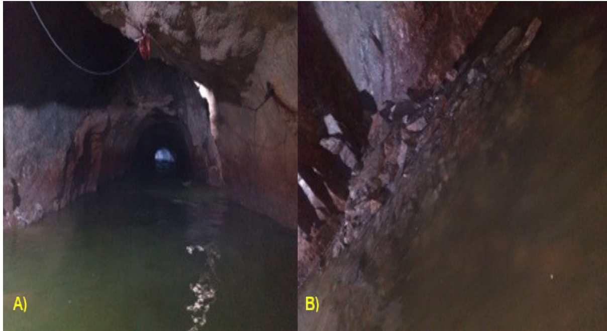
Figura 6.2-5. A) Situação em 07/01/21 após limpeza das quedas de blocos de 28/12/20. B) 11/01/2021 Mostrando novas quedas de blocos após limpeza concluída em 07/01/21.
