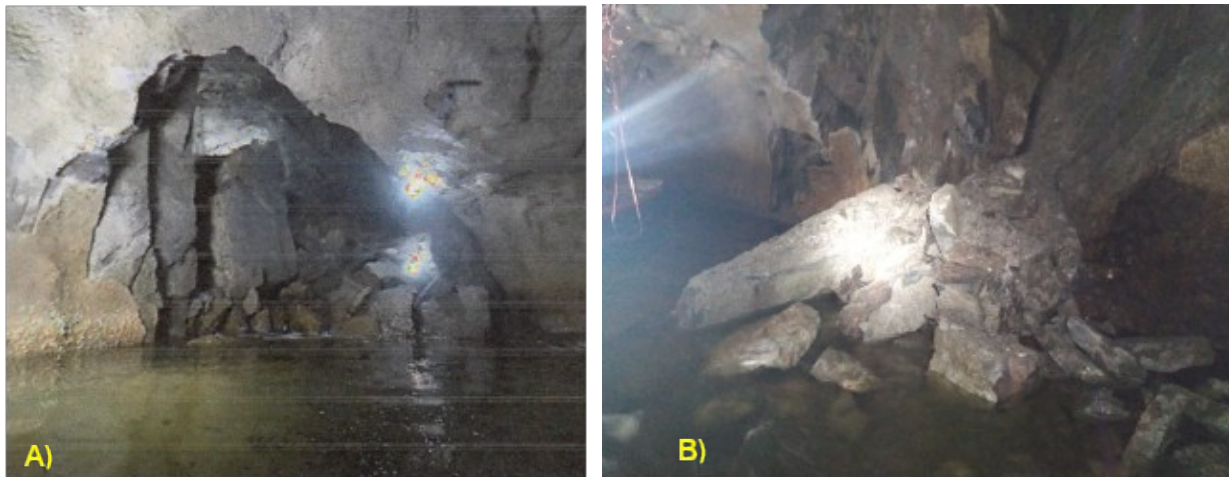
Figura 6.2-1. A) Na vistoria de 28/10/2020, na área do colapso de 110m foi identificado blocos que deveriam ser desmontados, pois configuravam risco de ruptura. B) Situação em 24/11/2020 mostrando as rochas desmontadas após a recomendação.
