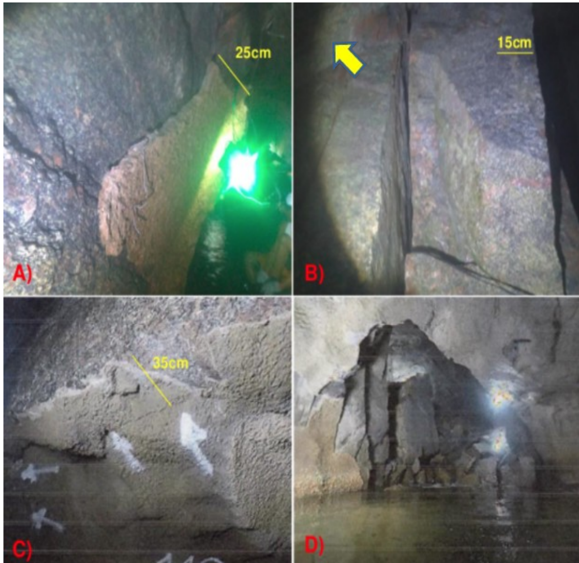
Figura 6.4-3. Observações sobre o concreto projetado: A) Trecho da capela de 110m de concreto com fibra metálica, de espessura ainda assim inferior a 5cm; B) Transição de concreto projetado na parede do túnel no trecho de 110m, mostrando uma espessura mínima do concreto; C) e D) Trecho do limite da capela, para sul e a apresentação da camada de espessura mínima possível de concreto jateado, em desacordo com o memorial descritivo.
