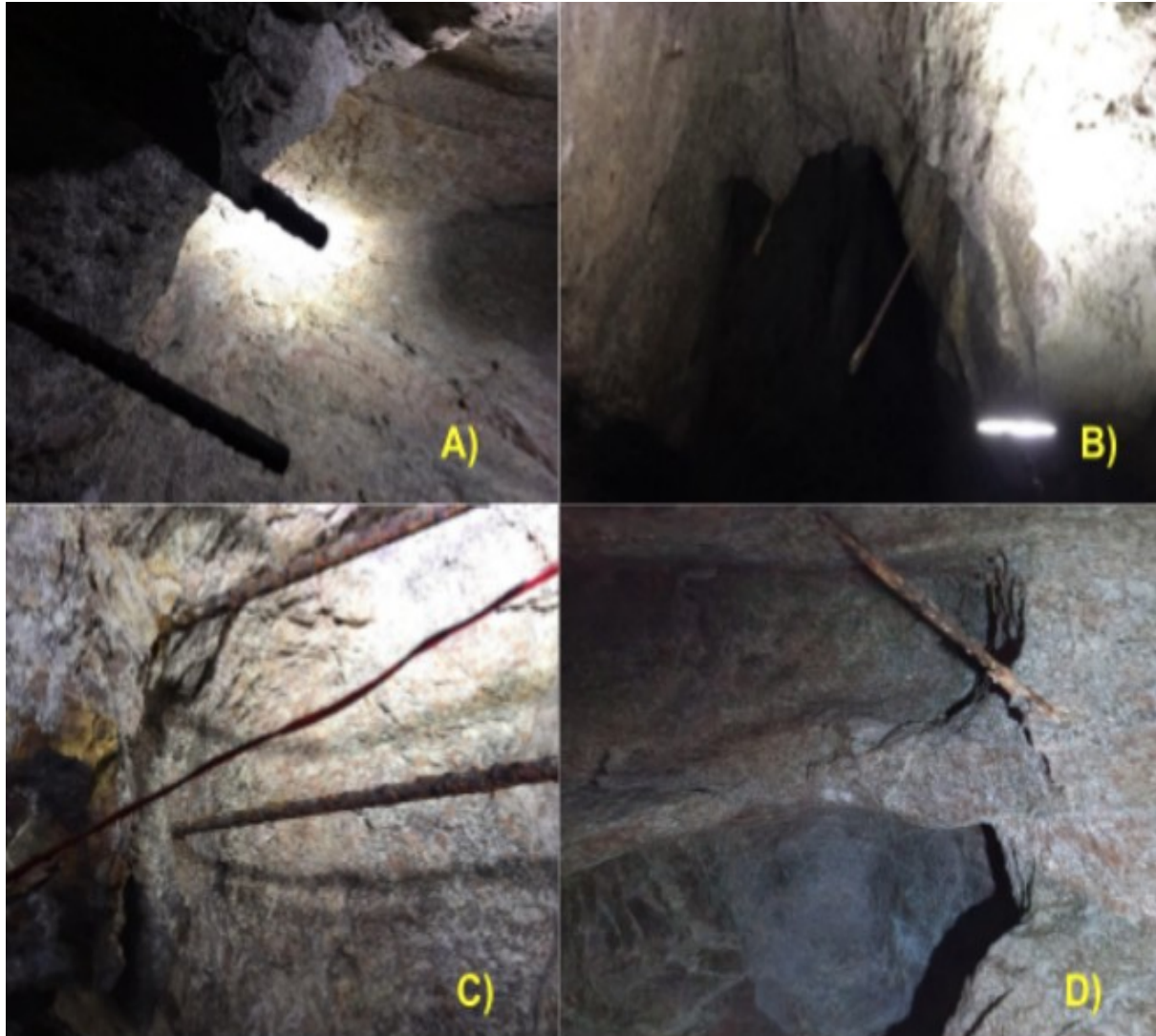
Figura 6.4-2. Observação de diversos trechos do túnel com elemento fixador, com hastes completamente danificadas por corrosão, e destaque para a pequena dimensão da cabeça.
